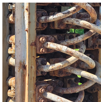
Abb. 4: Gegenstromkühler, 1967, von Burckhard aus Basel, 30 Jahre in Betrieb
