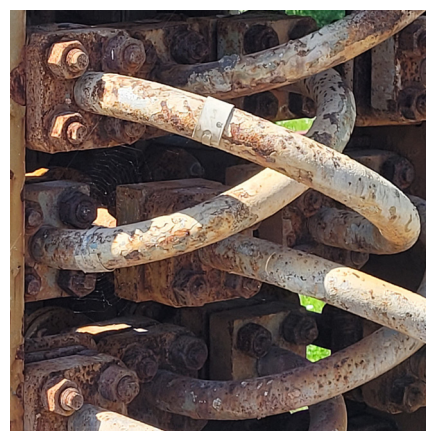
Fig. 4 : Refroidisseur à contre-courant, 1967, de Burckhard à Bâle, 30 ans en service
